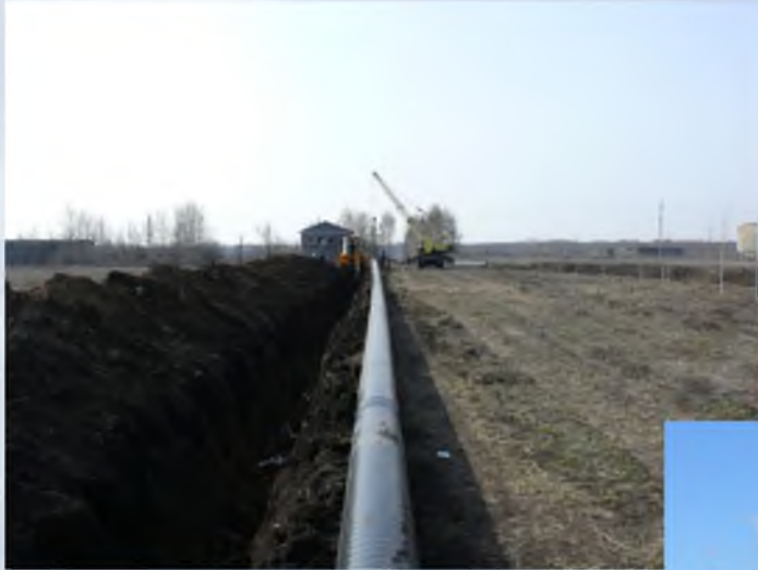
Gasleitung mit Hochdruck
